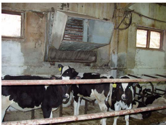
Рис. 13. Расположение утилизационной установки в помещении с полимерным теплообменником
